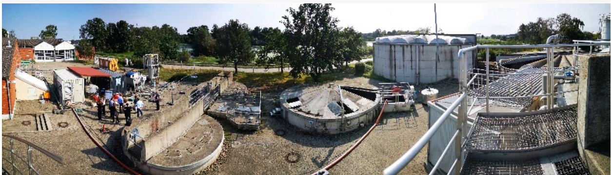
Versuchskläranlage in Braunschweig
