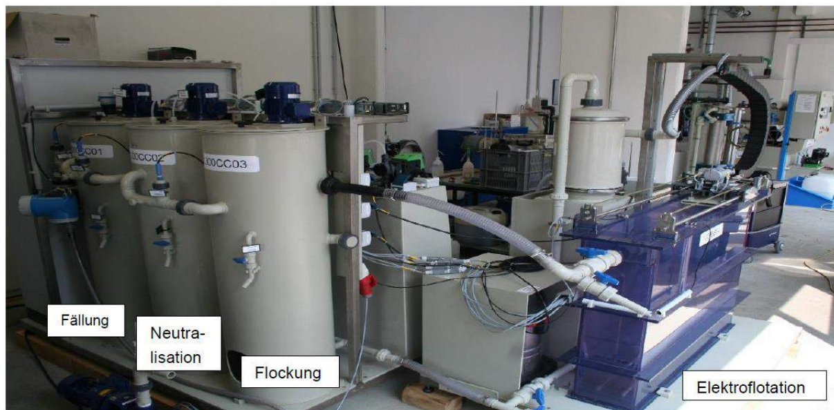
Abbildung 74: Elektroflotation mit vorgeschalteter Fällungs- und Flockungsstrecke in Weitwinkelansicht
